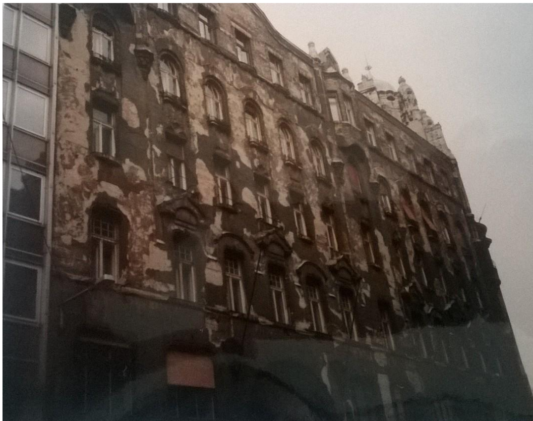
5.1. kép. A homlokzaton sok helyen mállott a vakolat (Forrás: Gresham palota kutatási dokumentáció, Forster Központ)
